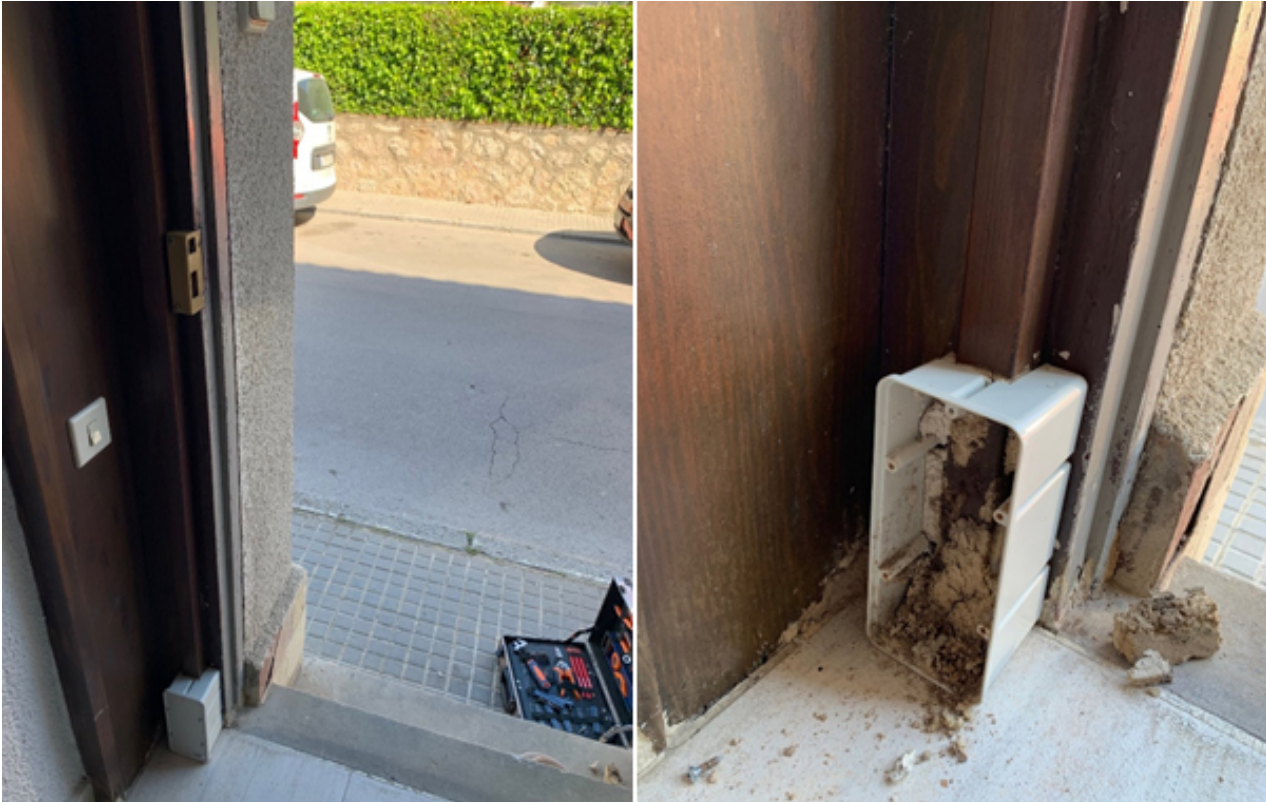
Figura 4. Ubicación de la caja-cebo para termites en el marco de un portal infestado (A). Detalle de la caja-cebo abierta (B).
